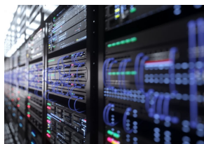
データセンター
