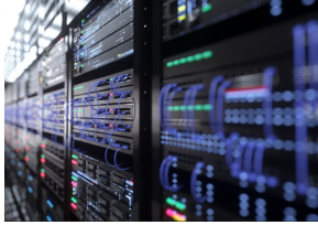
データセンター
