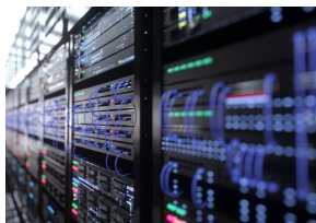
データセンター
