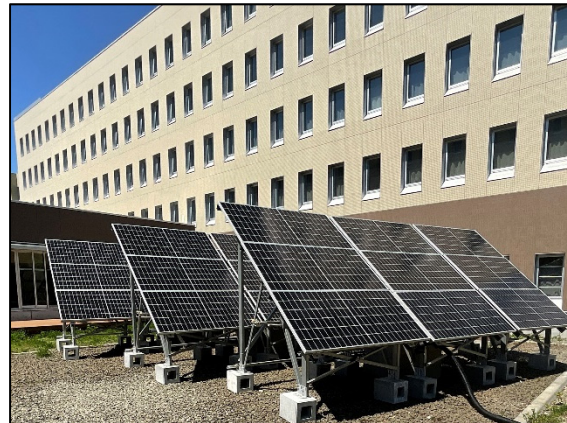
太陽光パネル
